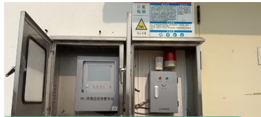
针对 SF 6 气体泄漏措施 - 安装 SF 6 气体报警装置
