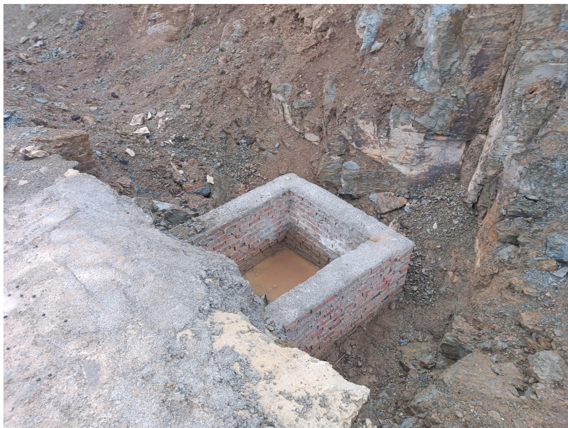
图 3.18 土质边坡配套沉沙池（2023 年 6 月）
