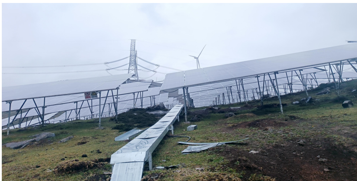
图 3.9 光伏区桥架电缆对地表扰动情况调查（2023 年 8 月）
