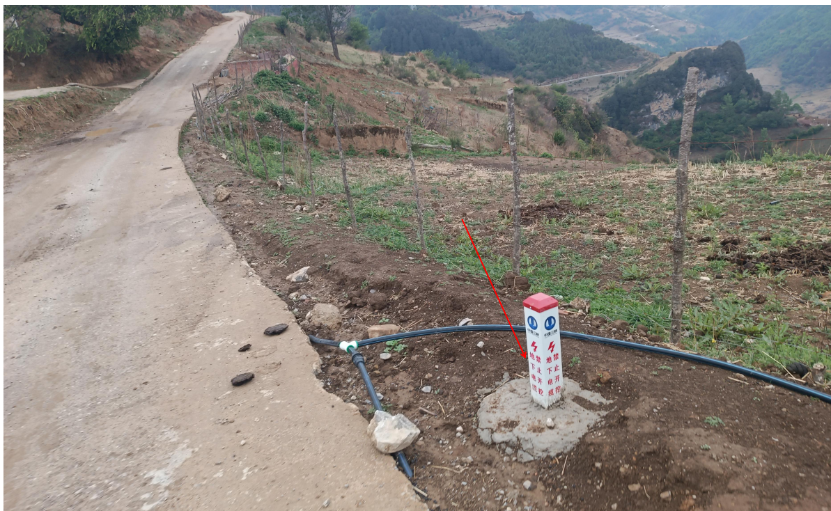
图 3.10 集电线路工程区植被恢复情况（2023 年 6 月）
